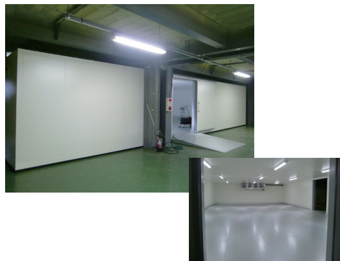
倉庫内設置プレハブ冷凍庫 外部・内部
